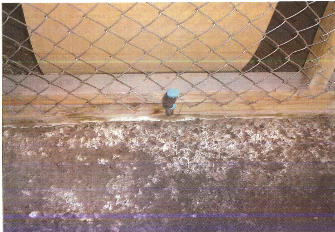
Et slags saltutslag på sviller som ligger direkte på bakken.
