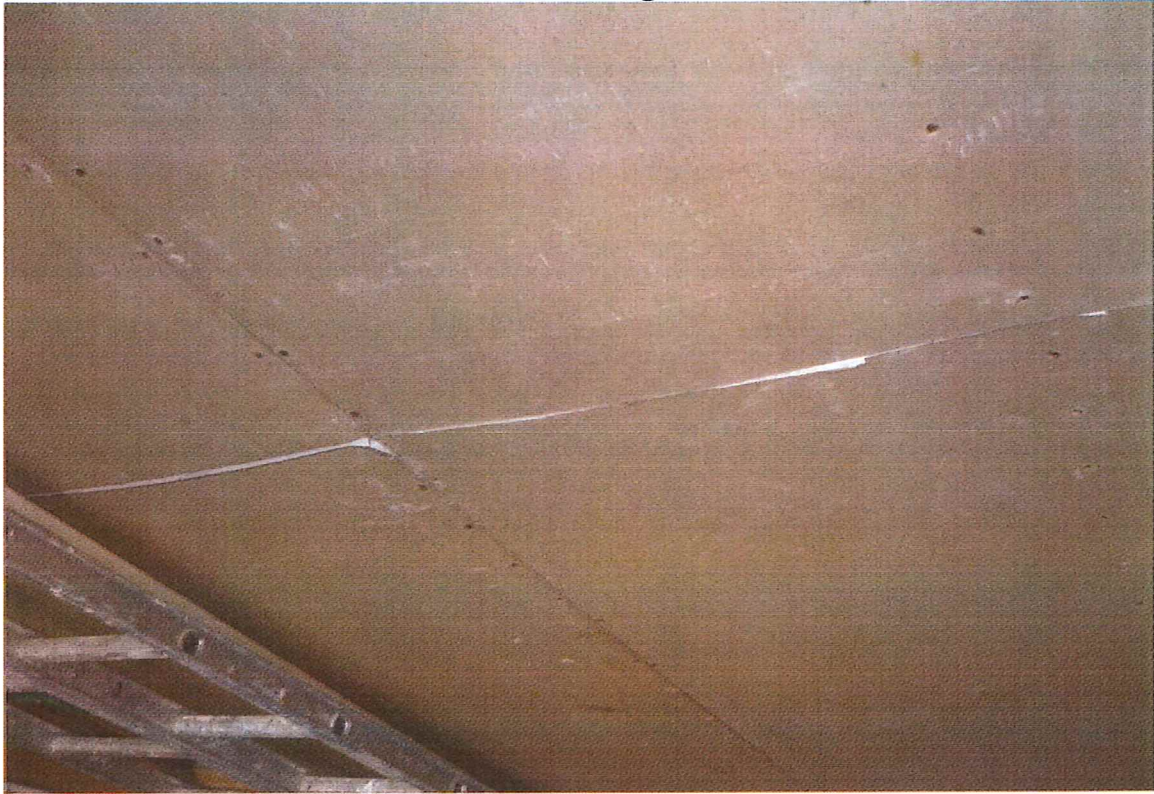
I noen er det gipsplater i himlingen.
