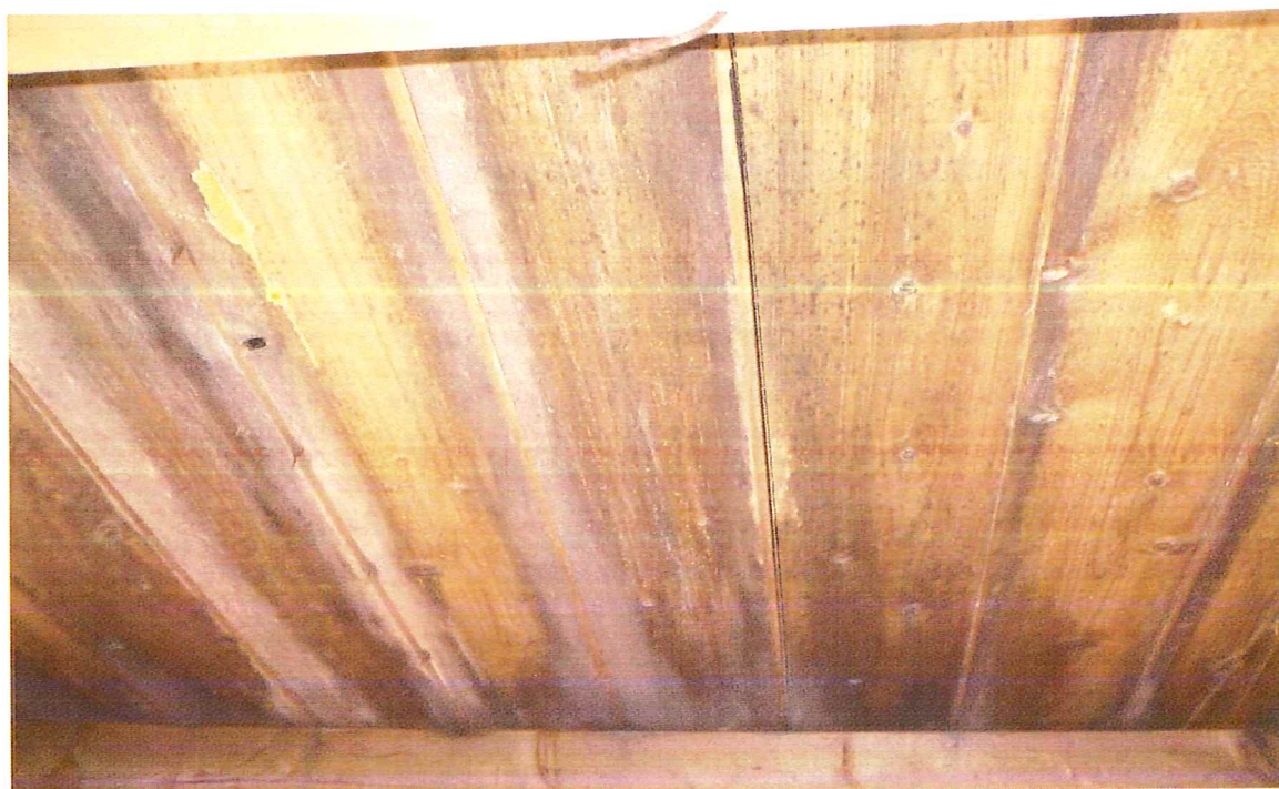
Undertak og tilstand, noe svertesopp.
