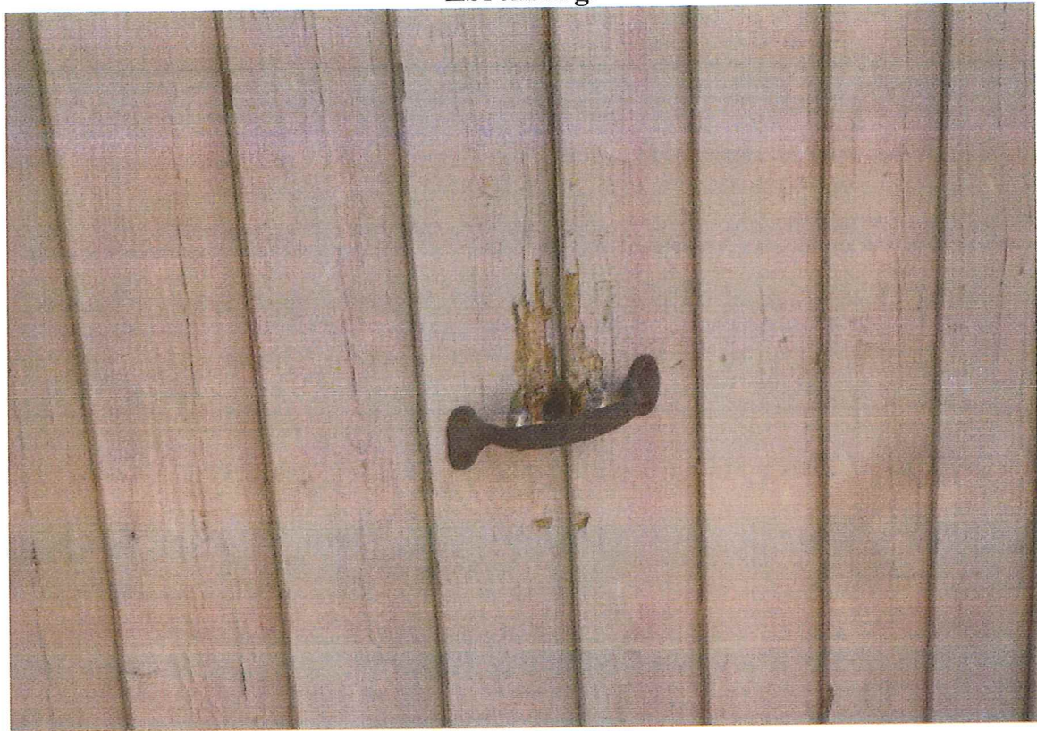
Skader detaljer, vegger porter.
