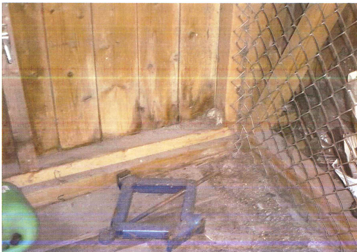
Fuktige ender på panel, begynnende mugg/råte.
