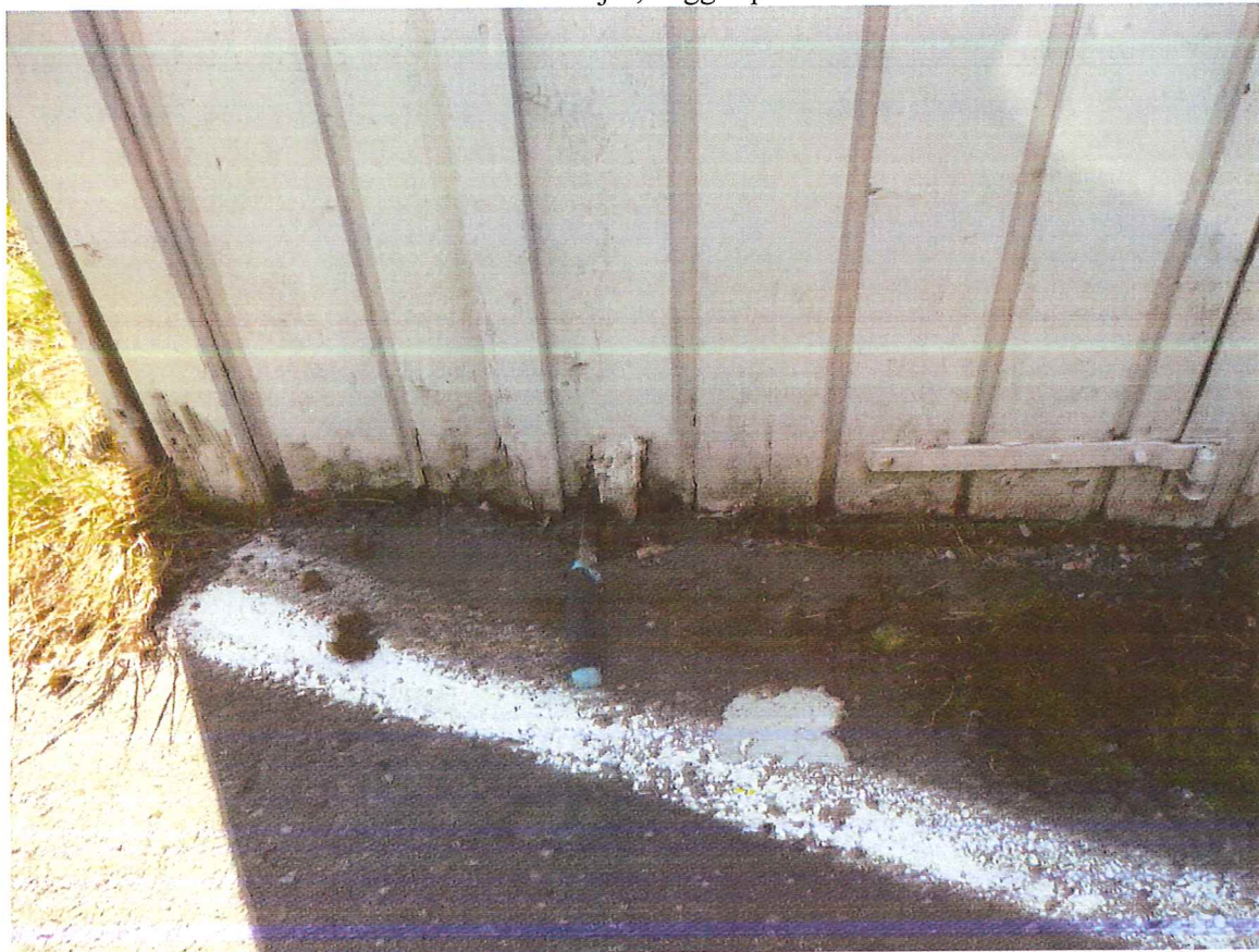
Skader detaljer, vegger porter.
