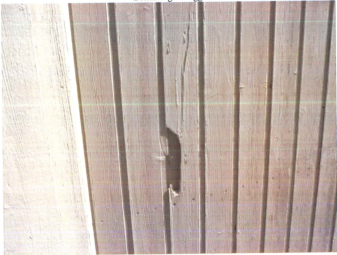
Skader på port er det vel.
