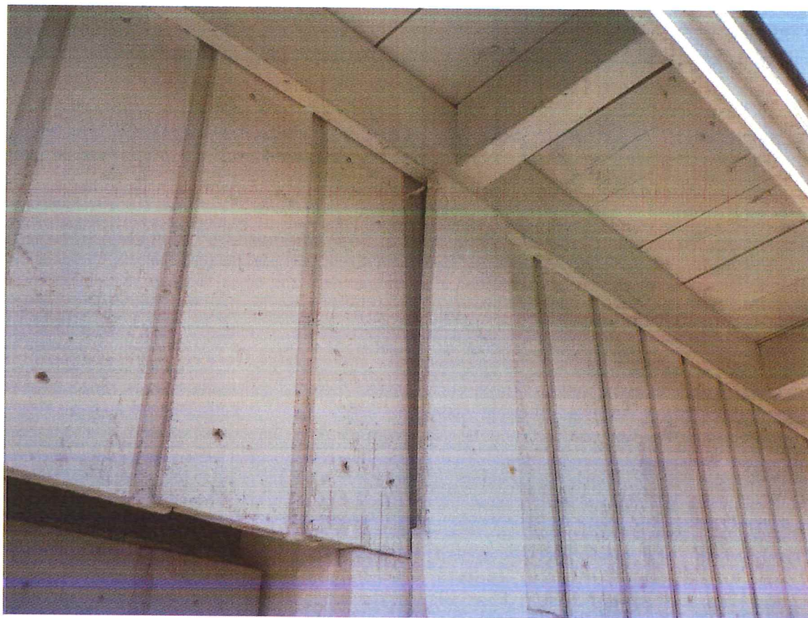
Skader detaljer, vegger porter.
