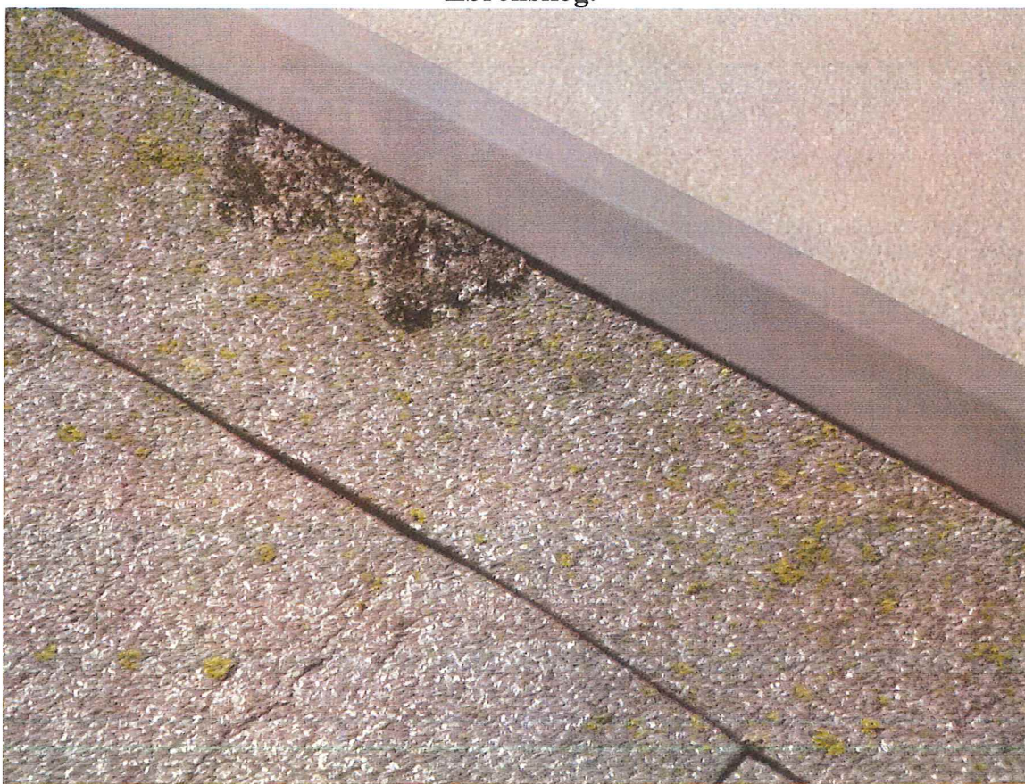
Skade på tekking.
